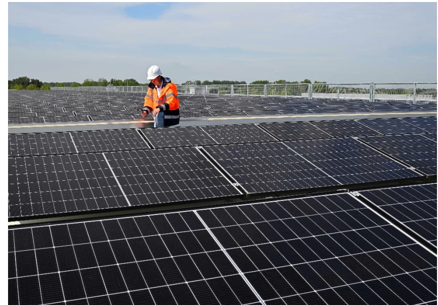
Am Münchner Flughafen erzeugen Solarpanels erneuerbaren Strom für Bayerns größten Ladepark.
